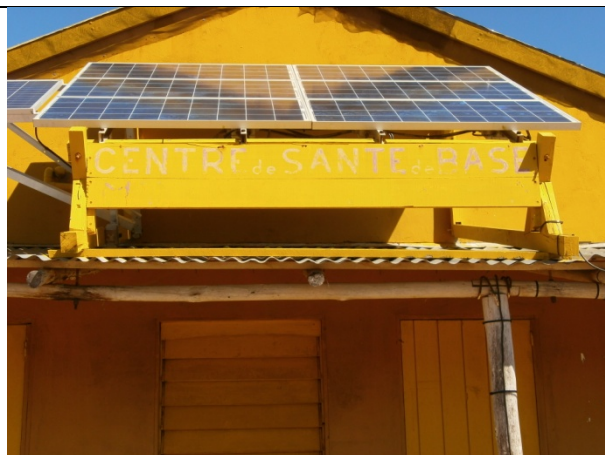
Aperçu des panneaux solaires
